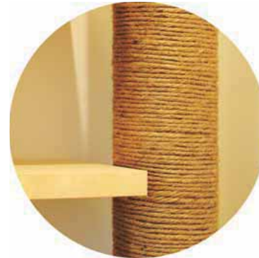
麻縄を巻いた排水管
